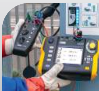
Controllo delle tensioni erogate da una morsetta con DDR di tipo B/EV 6 mA durante la carica
